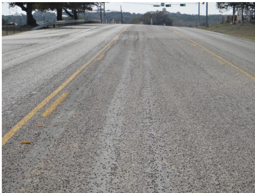
19. att. Šķembu lobīšanās uz SS virsmas ( http://onlinemanuals.txdot.gov )
