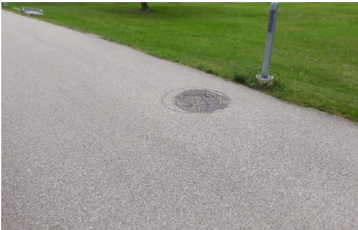
30. att. Posma beigas ar vienu izteiktu seguma lokālu bojājumu – iesēdumu ar noguruma plaisu tīklu
