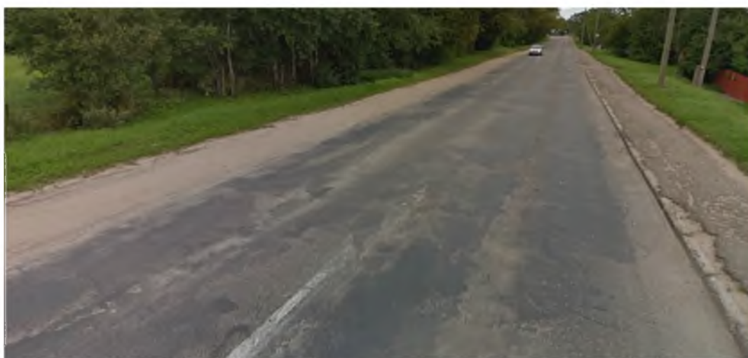
15. att. – Brīvības ielas posms pie Kalna ielas – ielas segums ir maģistrālājai ielai neapmierinošā tehniskā stāvoklī
