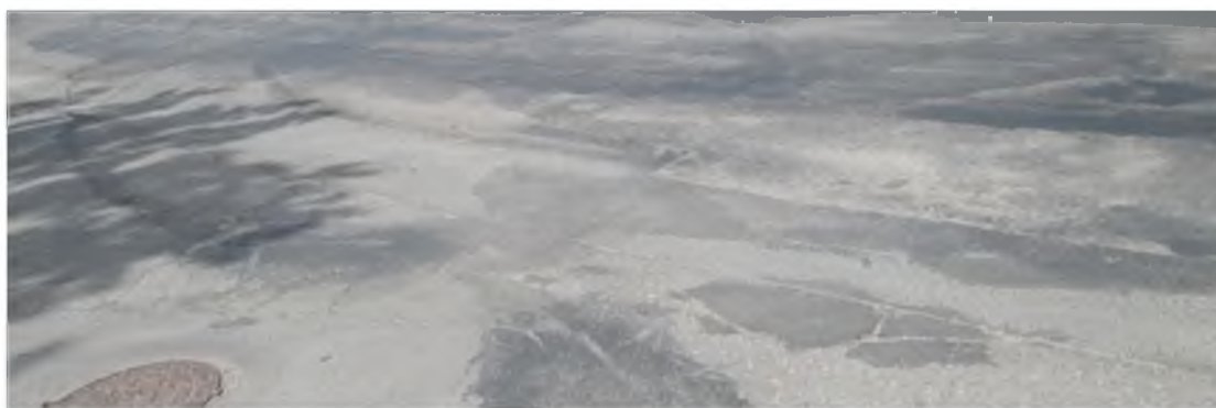
2. att. – Brīvības ielas posms starp Skrundas un Rūpniecības ielām – asfaltbetona segums pēc pazemes inženierkomunikāciju remonta ir atjaunots, bet atjaunotā seguma kvalitāte ir ievērojami zemāka par sākotnējo – ielas posmam nepieciešama seguma renovācija
