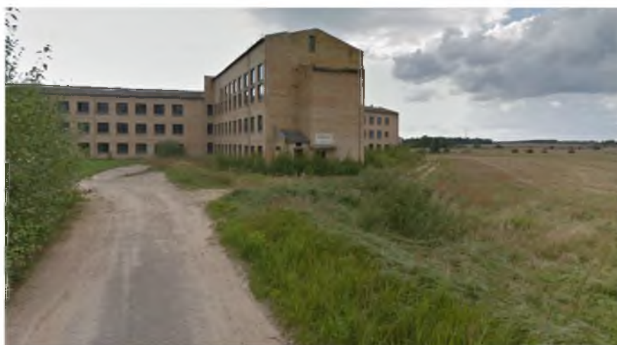
51. att. – Skats uz ēku, ap kuru nav izbūvēta ceļa segas konstrukcija - jaunā savienojuma posmu nepieciešams „apliekt” ap doto ēku pa labo pusi
