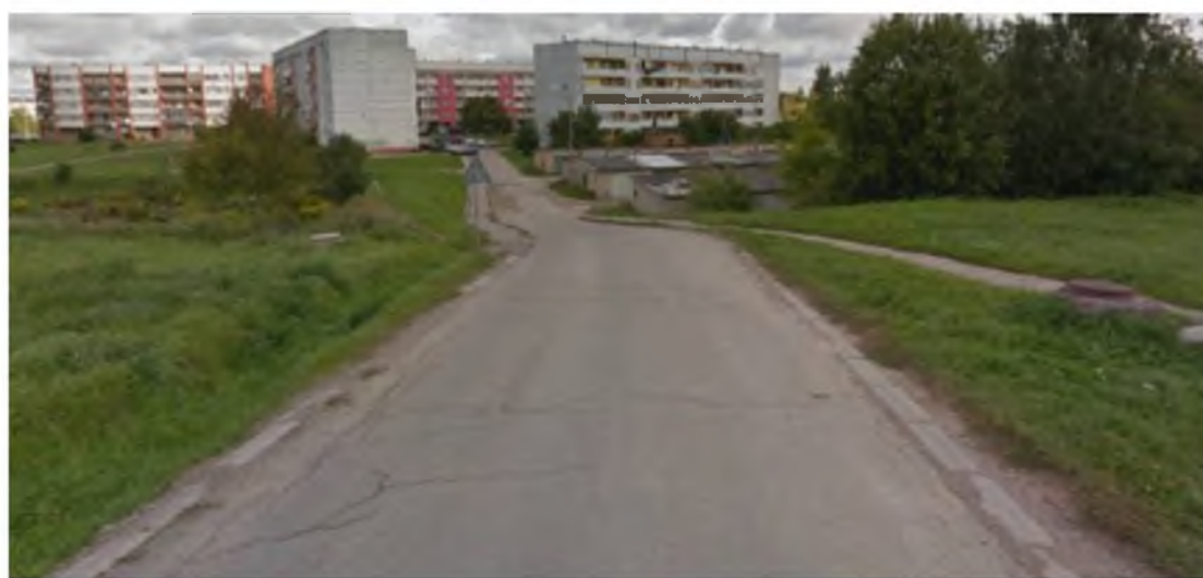
3. att. – Cieceres ielas posms ar loti augstu satiksmes drošības risku –nepieciešama brauktuves un ietves seguma rekonstrukcija, kā arī horizontālo apzīmējumu uzklāšana
