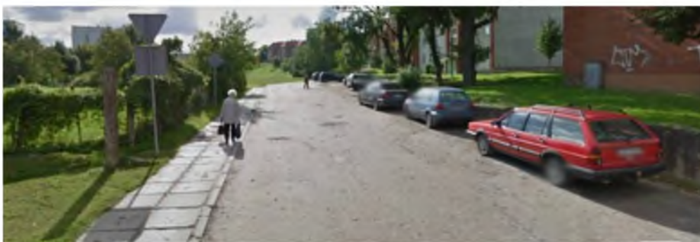
1. att. – Tūristu ielas posms pie Rīgas ielas – saplaisājis un bedrains ielas segums palielina mehānisko transportlīdzekļu remonta izmaksas un rada negatīvu psiholoģisko efektu
