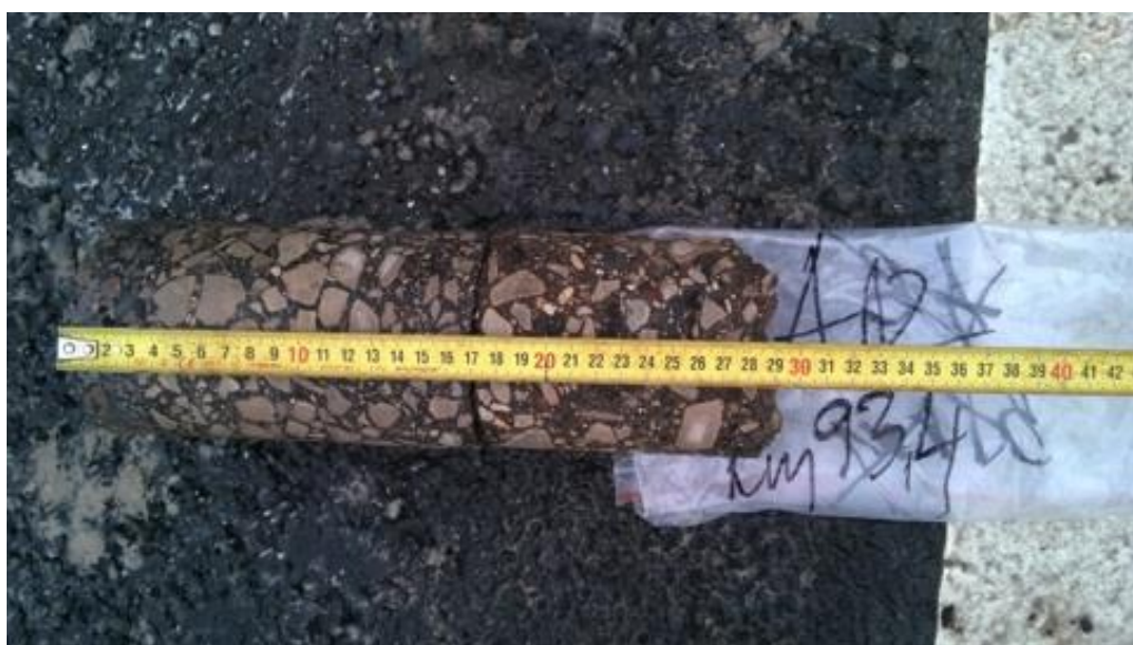
8-9 attēls. Izurbtais asfalta un reciklētās kārtas paraugs 93,4 km
