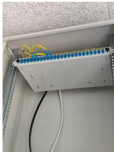
2.8. Optisko šķiedru kabeļu sadales panelis (ODF) iekštelpu sadales skapī
