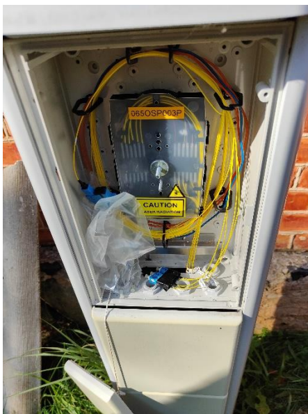
2.7. Ārtelpu optisko šķiedru kabeļu sadales skapis ar atvērtām durvīm
