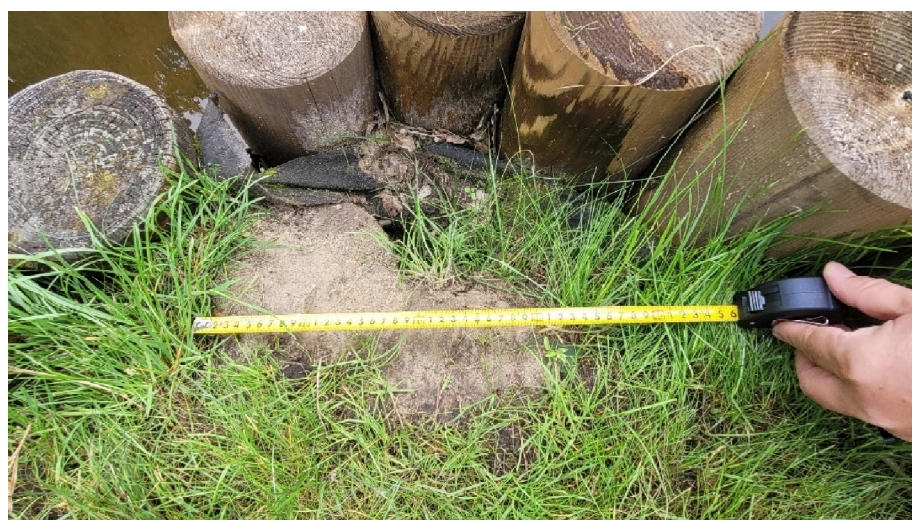
Attēls Nr.12. Skats uz grunts erozijas vietu
