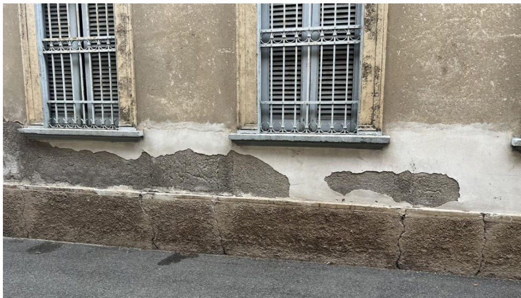
5.2. attēls. Apmetuma atdalīšanās un mitruma bojājumi sienas konstrukcijās
