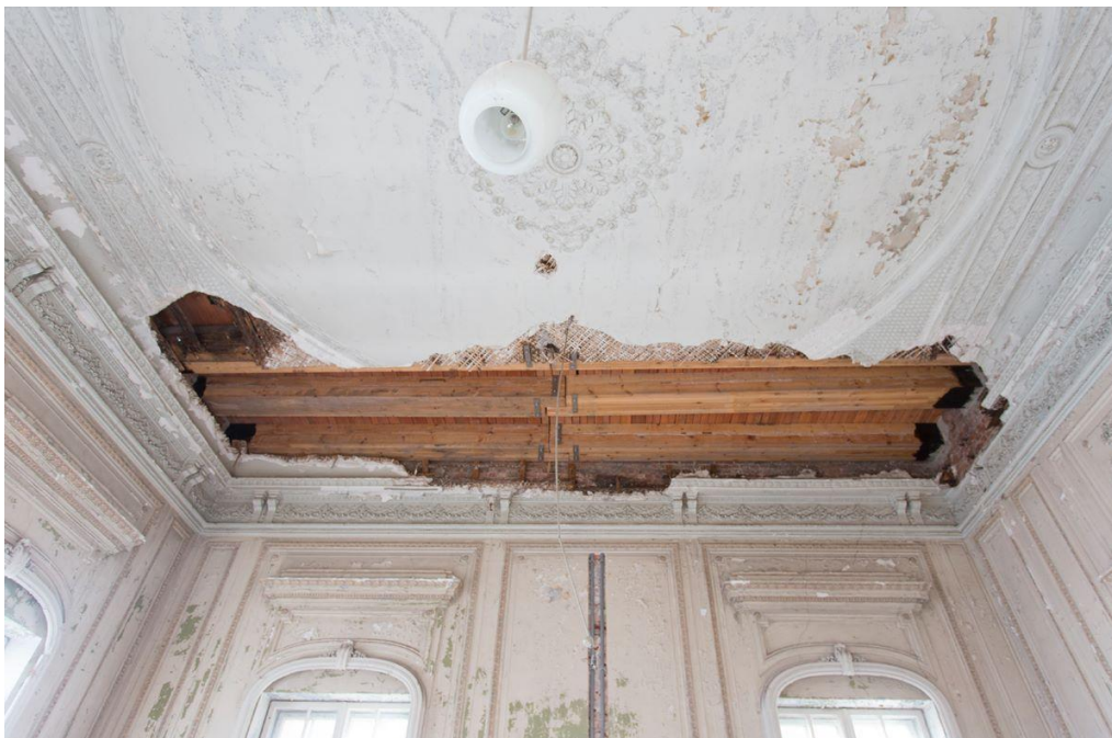
5.1. attēls. Iekštelpu bojājumi no mitruma uzkrāšanās jumtā vēsturiskajā Virsnieku saietā namā, Liepāja, 2015.g.
